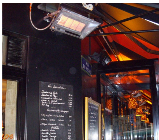
Chauffage au gaz d'une terrasse de bar (IVe)
